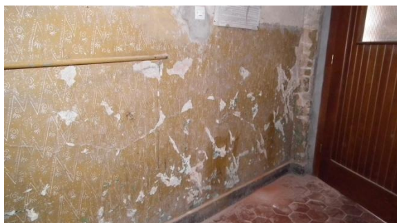
Fot. 3. Przedmiotowa ściana.
