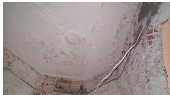
Fot. 4. Wysolenia na suficie z przecieków z tarasu
